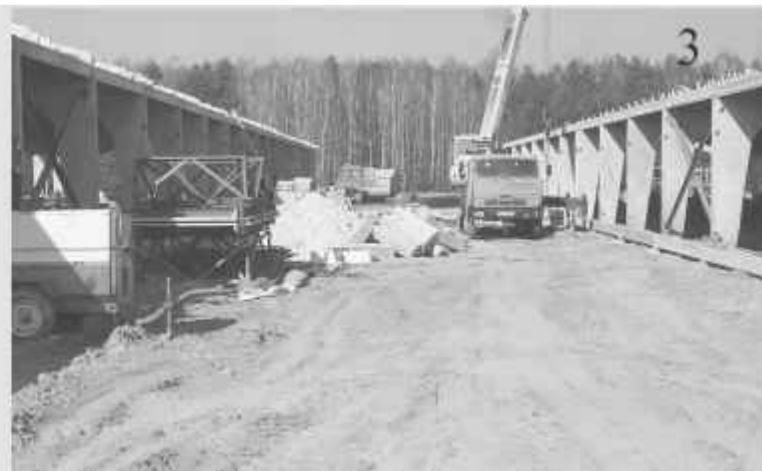
С нарушением» выполнено складирование фундаментных блоков' на строительной площадке аSpf» (изделия; хранятся навалом). (Филиал Зельвенская МПМК-148")
