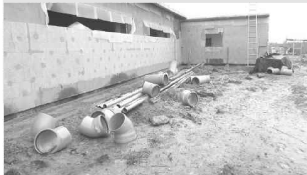
Материалы и изделия (трубы ПВХ и отводы) разбросаны по строительной площадке (филиал "Гродненская СПМК-61").
