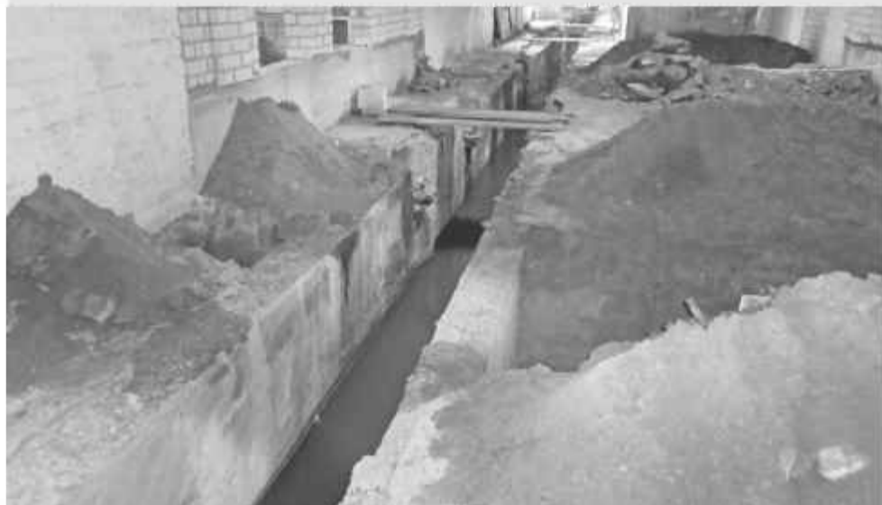
Не ограждены перепады по высоте по всей длине канала. Переходные мостики не соответствуют нормативным требованиям (филиал "Гродненская СПМК-61").
