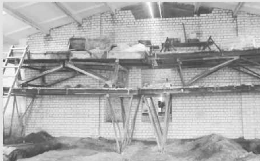
В процессе строительства используется приставная лестница, не соответствующая нормативным требованиям. Категорически запрещено использование в процессе строительства шарнирно-панельных подмостей, установленных одни на другие (филиал "Лидская ПМК-169").
